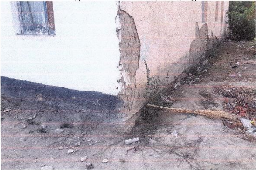
Сирдарё вилоят Бобоўт тумани Бобоўрт МФЙ ҳудудда жойлашган №39-сонли умумтаълим мактабига қарашли эски бинонинг ташқи томондан кўриниши
